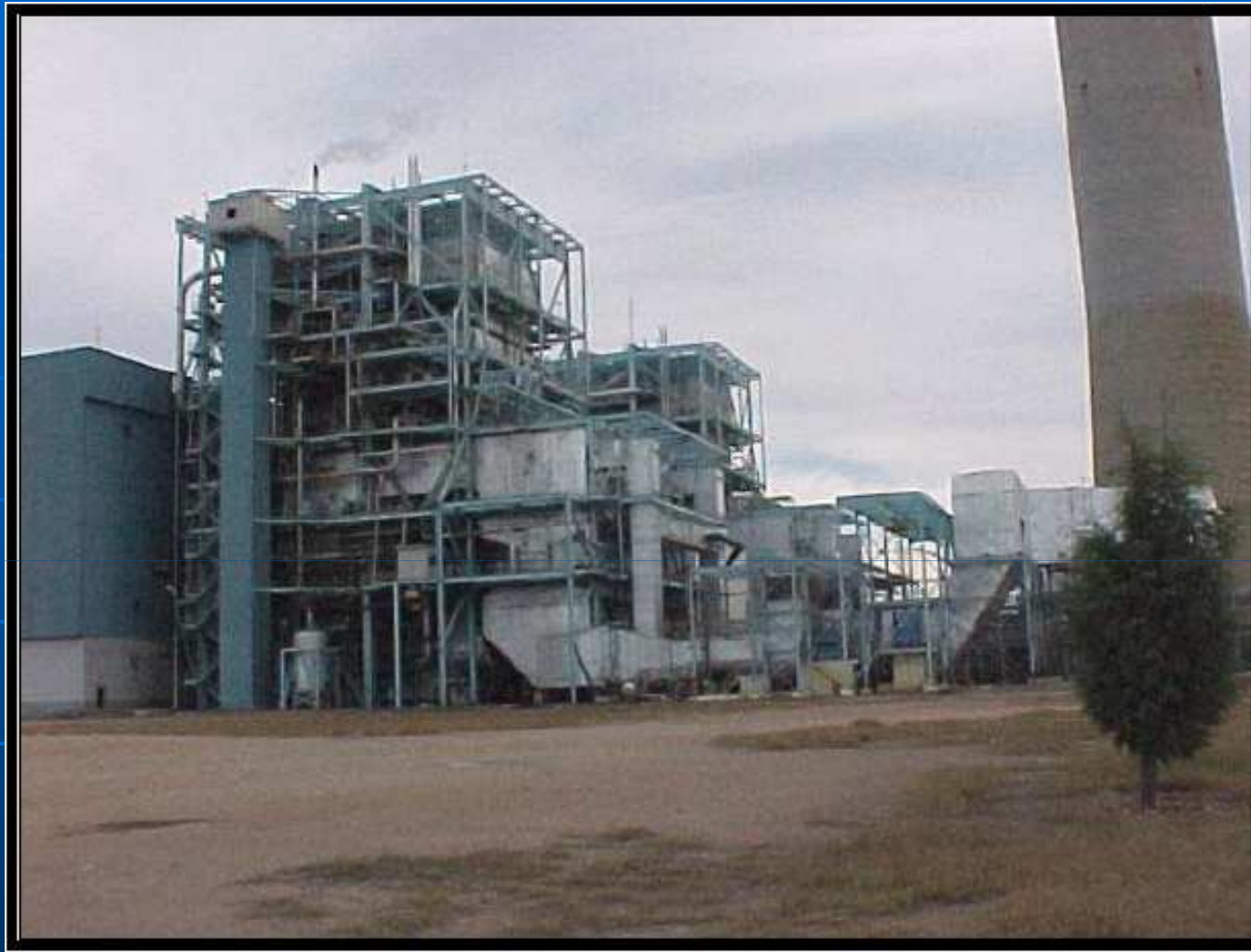
Generador de vapor de 350 MW
